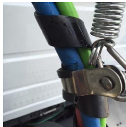
Photo sur le terrain : Mâchoires du collier trop serrées
