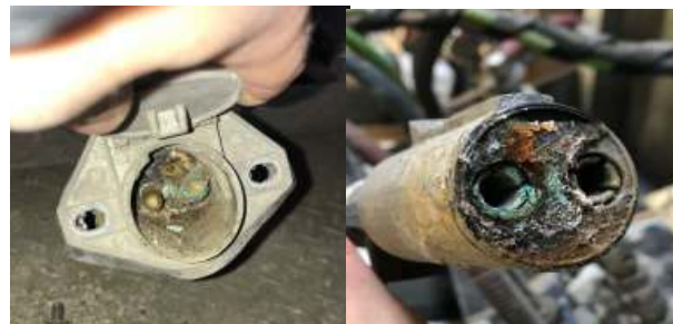
Prise bipolaire corrodée
