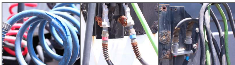
Conduite endommagée, ressorts rouillés
