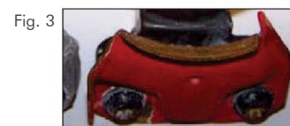
El plato conector presenta señales de corrosión
