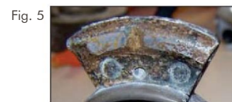
Plaque crantée corrodée
