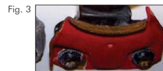
Plaque de connexion montrant des signes de corrosion
